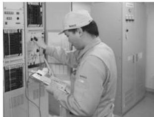
防災行政無線設備点検
