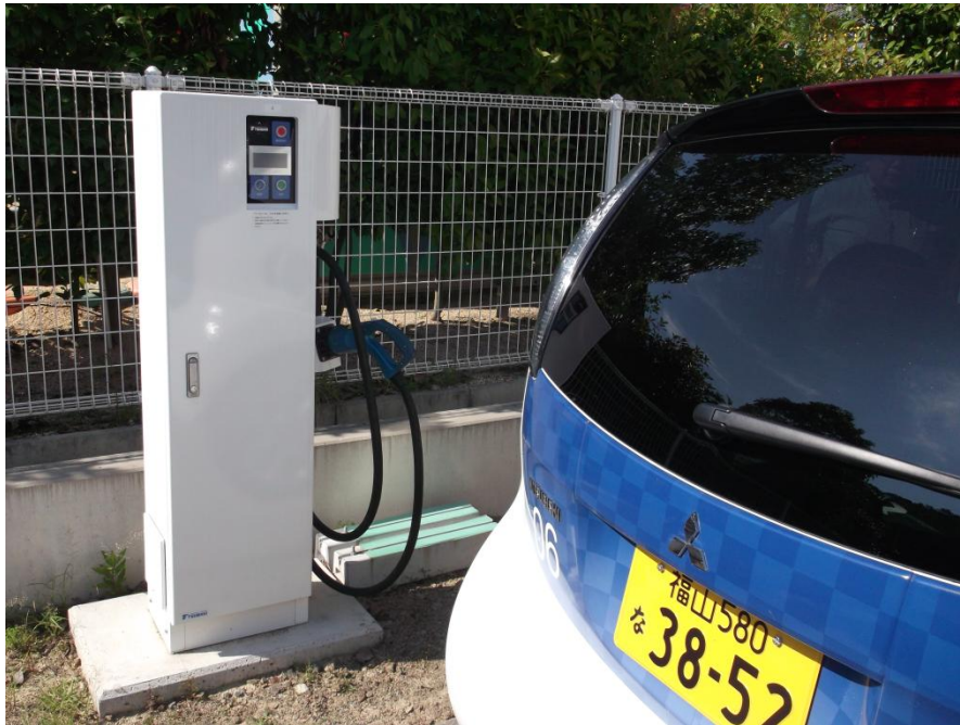
写真. 社宅に設置された給電装置
