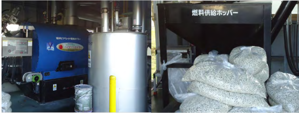
写真 22 紙おむつの燃料化（ペレット）による温泉加温設備
