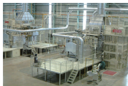
3t/h タワー型アルミ溶解炉
